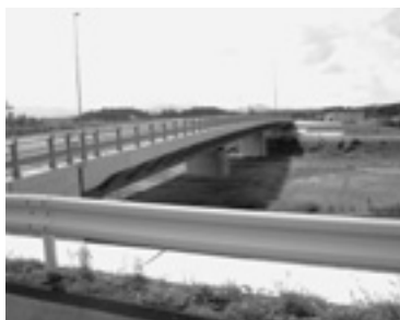
入西赤沼線(来年3月末開通予定)の越辺川大橋 坂戸側から鳩山を望む
