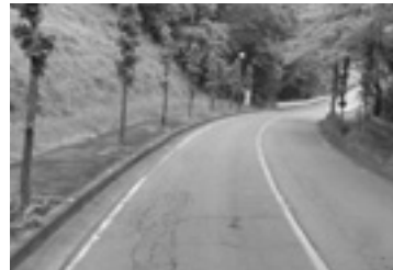
路面ひび割れ(N.T松ヶ丘三丁目) 町道第2766号線
