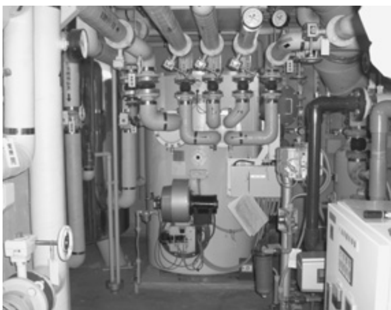
鳩山町総合福祉センター機械室
