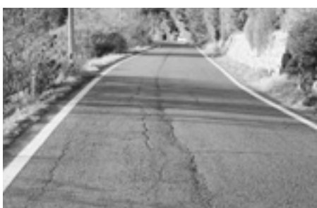
様々な理由で路面補修を見送った町道52号線
