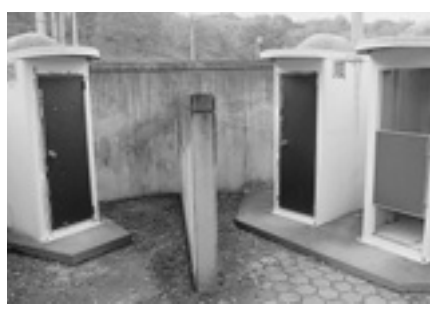
早急に改装工事が待たれる梅沢運動場トイレ
