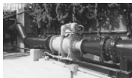
落差2メートルの水力発電機
