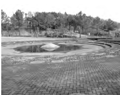
石が剥がれて危険なジャブジャブ池
