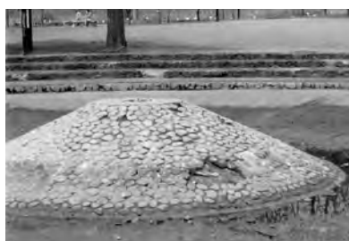
劣化が著しいジャブジャブ池
