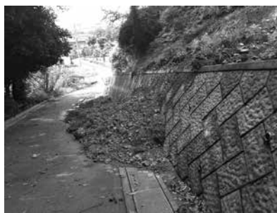
おしゃもし山公園内、通学路の土砂崩落
