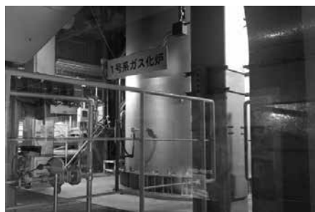
流動床式ガス化溶融炉
