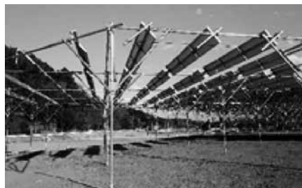
営農用太陽光発電装置（高野倉地内）
