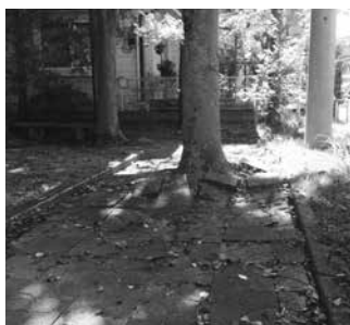
危険を伴う根上がりした公園樹木
