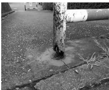
寄りかかる等で崩壊し、負傷する危険もある
