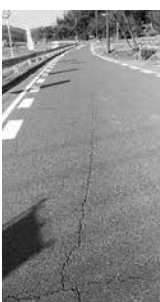
狭く、ひび割れて危険な道路
