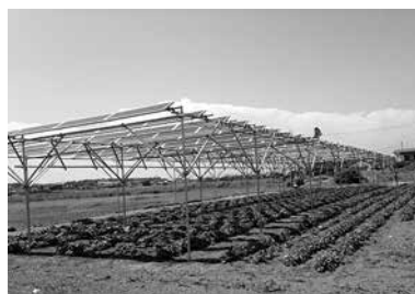
営農型太陽光発電施設
