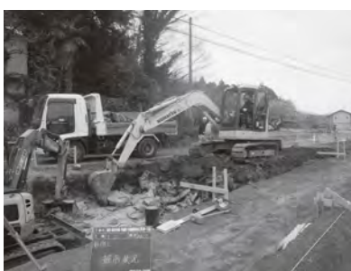
残土処分予定超過の町道第1号線
