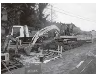
残土処分予定超過の町道第1号線
