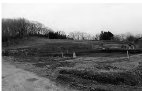
伐採工事が終わった石坂地内の太陽光発電施設設置場所
