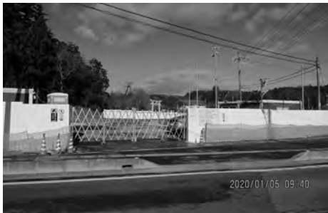
令和2年1月、新築工事が中断したままの上熊井集落センター
