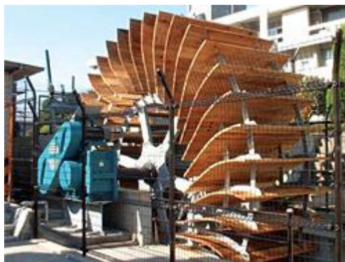
家中川小水力市民発電所（最大出力 20kW） （出典：経済産業省資源エネルギー庁 HP）
