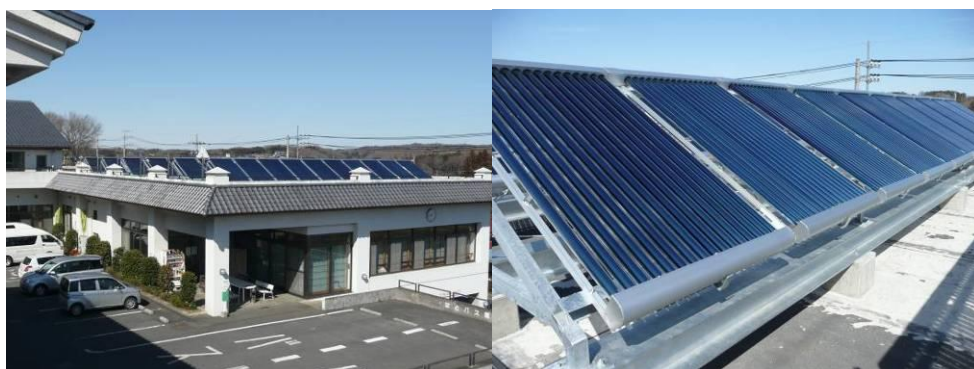
鳩山町総合福祉センターの太陽熱集熱器
