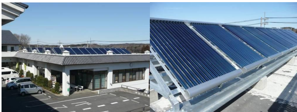
鳩山町総合福祉センターの太陽熱集熱器
