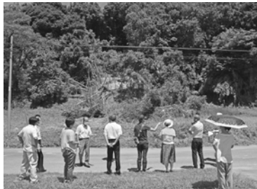
満願寺周辺の土砂崩落現場
