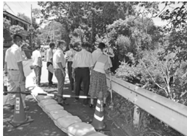
楓ヶ丘3丁目の土砂崩落現場
