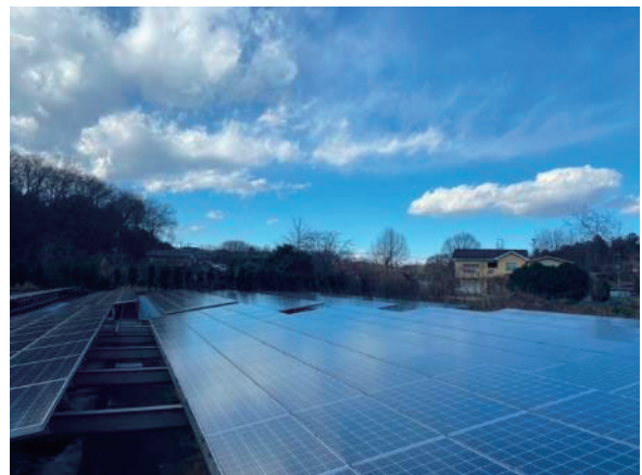
町内の太陽光発電施設
