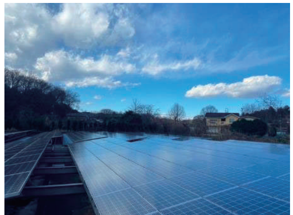
町内の太陽光発電施設
