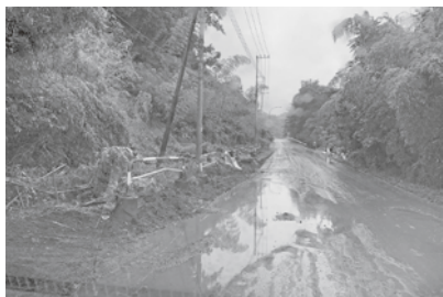
大雨のたびに冠水する重郎橋付近の県道
