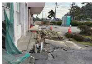
▲被災状況(石川県七尾市内中学校)
