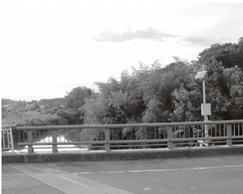
大雨の度に冠水する重郎橋
