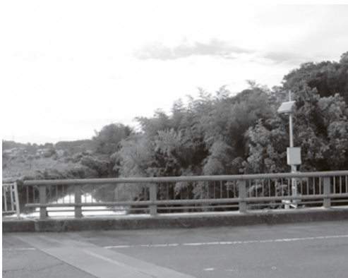
大雨の度に冠水する重郎橋
