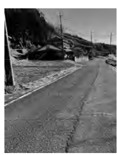
15年以上前から改修工事の要望書が提出されている52号線高野倉地区
