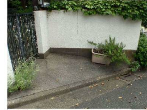
写真④: 宅地側コンクリートのクラック
