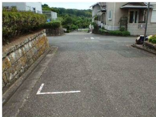
写真⑫: 路面に無数のクラック
