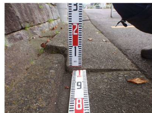
写真⑫: L字ブロックの段差 (30mm 程度)
