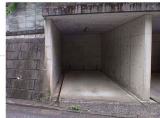
写真⑤: ガレージ内クラック (2mm 程度)、奥側の排水跡
