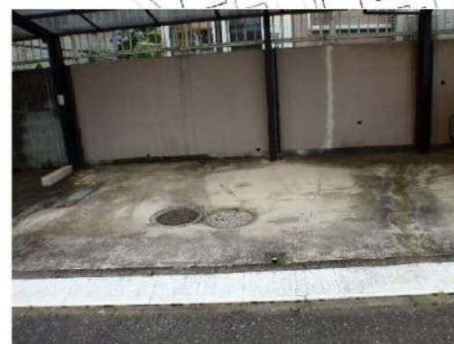
写真⑩: 駐車場内部表面のクラック
