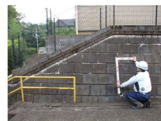
写真⑧: 階段部側面の宅地擁壁のクラック (1mm 程度)
