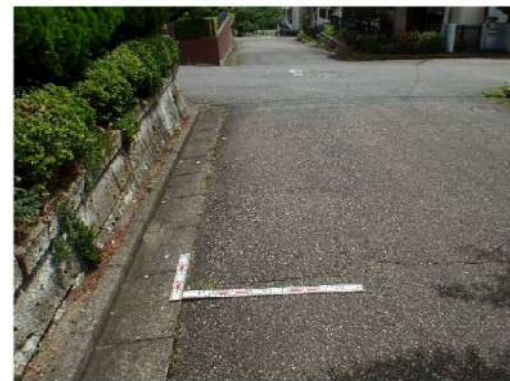
写真⑬: 路面のクラック (2~5mm 程度)
