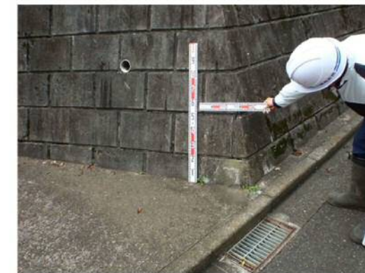
写真④: 階段下部の擁壁クラック (5mm 程度)
