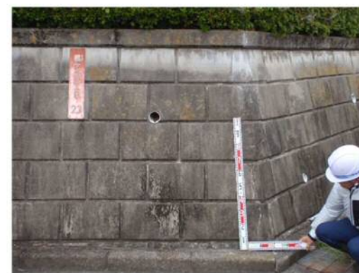
写真⑨: 宅地擁壁のクラック (2mm 程度)
