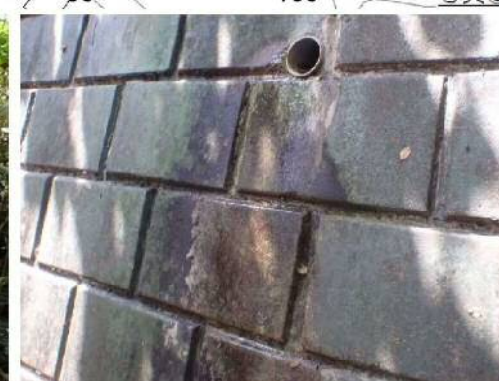
写真⑧: 末端部擁壁からの排水跡
