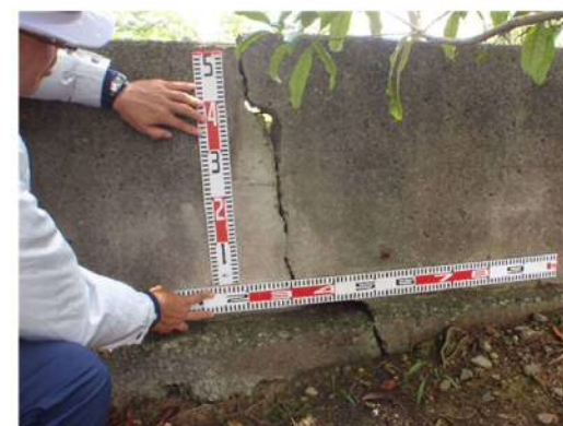
写真⑪: 公園内擁壁のクラック (5mm 程度)、スレ
