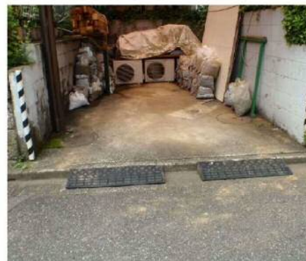
写真⑪: 駐車場内部表面のクラック
