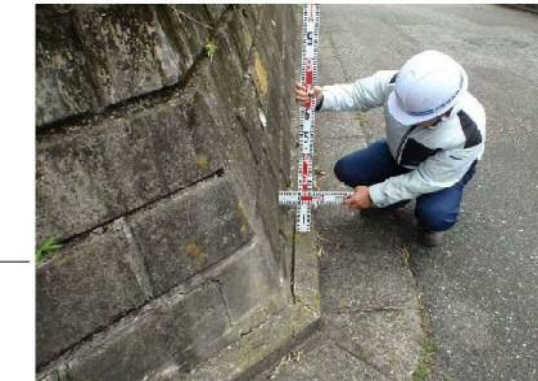
写真⑤: 宅地擁壁下部のL字コンクリートの開き
