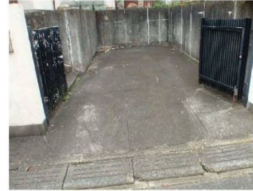
写真③: 駐車場内部の表面のクラック変状
