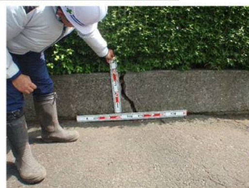
写真⑩: 公園内擁壁のクラック (40mm 程度)、スレ
