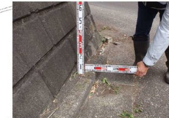
写真⑥: 宅地擁壁下部のL字コンクリートの段差
