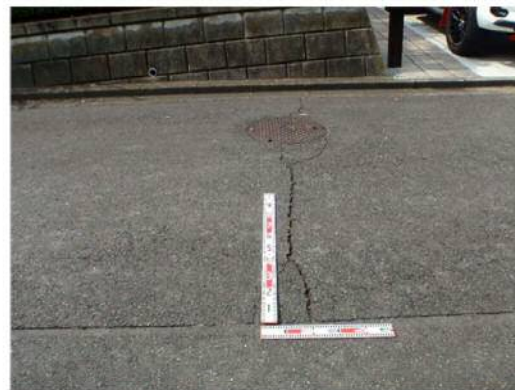
写真①: 路面のクラック (10mm 程度)
