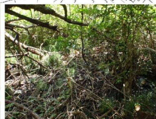
写真⑨: 末端部擁壁下部に水が溜まっている
