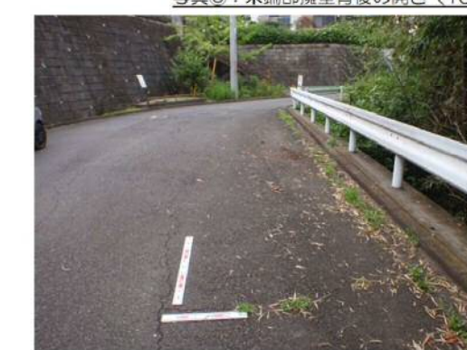
写真⑦: 末端部擁壁背後の路面にクラック (3mm 程度)
