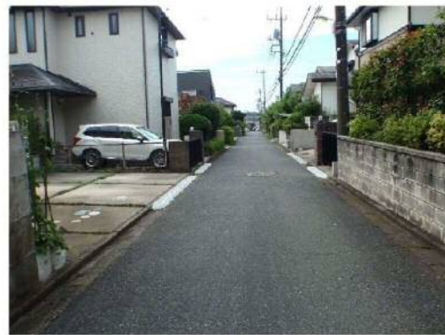
写真①: 盛土頭部付近の路面状況
