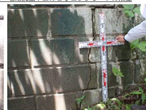
写真⑦: 末端部擁壁のクラック (10mm 程度)
