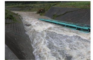
▲人道橋落橋(大橋川)
