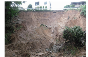
▲楓ヶ丘地区の路肩・法面崩落、側溝・ガードレール損壊・電柱・カーブミラー損壊
