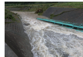
▲人道橋落橋(大橋川)
