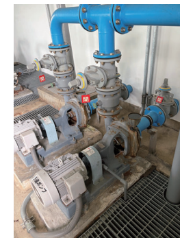
▲腐食が進行している浄水場のポンプ設備
