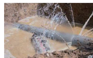
▲水が噴き出している地中の老朽管
