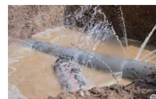
▲水が噴き出している地中の老朽管
