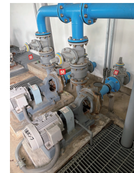
▲腐食が進行している浄水場のポンプ設備
